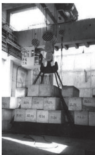
Мостовой монтажный кран 200/15/15 т на ГЭС «Дшар Эль Уэд» (Марокко)
