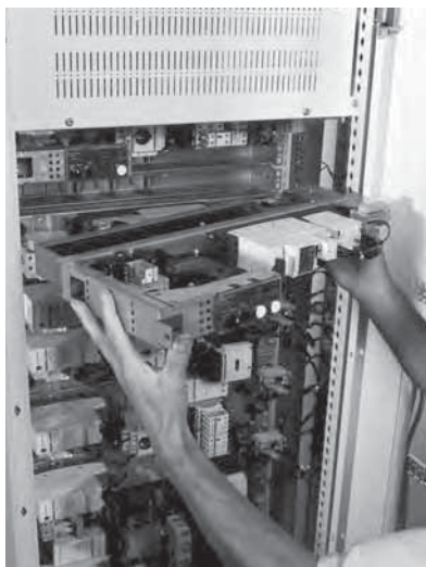
Рис. E31 : РУ с втычными функциональными блоками
