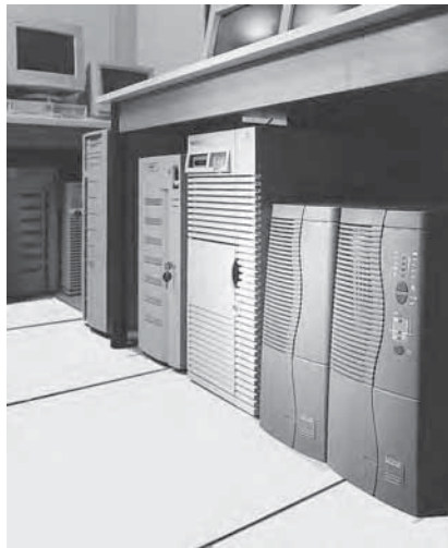
Рис. М30б : Блок ИБП, повышающий надежность, готовность и качество электропитания компьютерной системы
