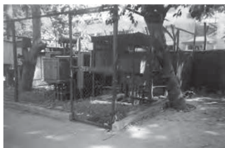
Рис. В39: Подстанция наружной установки без корпуса
