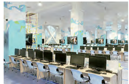
Главный медиацентр г. Сочи. Кабель-канал "In-liner Front"
