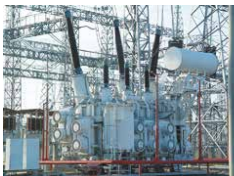
Электрические сети Электростанции, подстанции, линии электропередач
