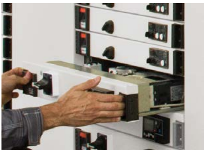
Рис. E32. РУ с выдвжными функциональными блоками
