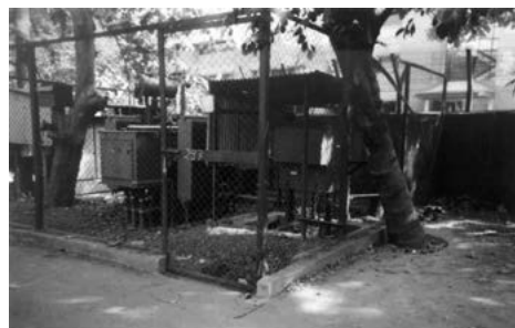
Рис. В54. Подстанция наружной установки без корпуса
